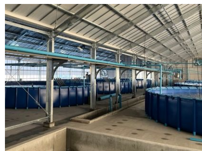
稼働中 循環システム
