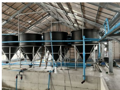
稼働中 濾過タンク
